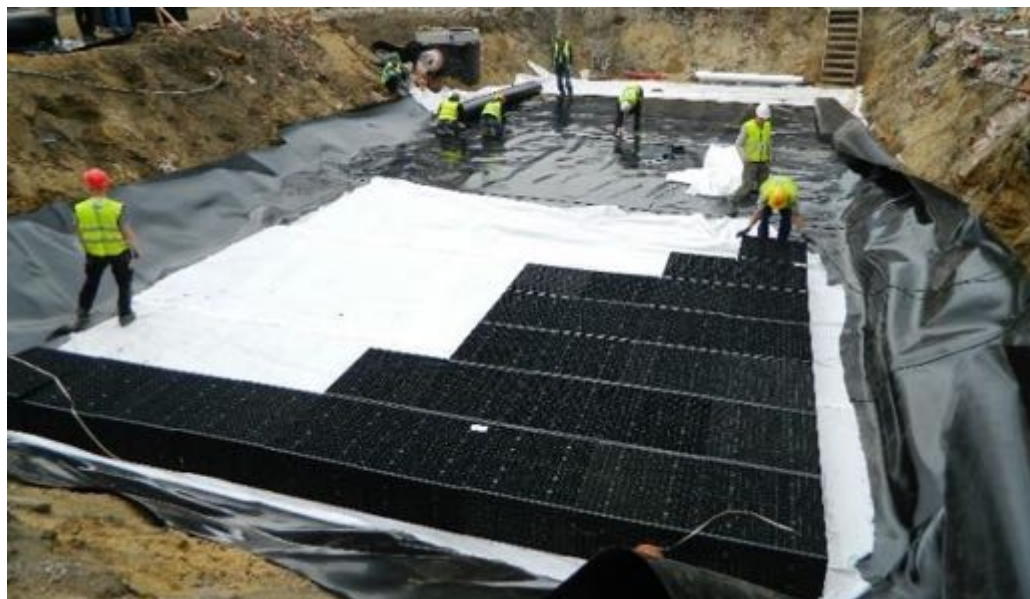
Zbiornik retencyjny ze skrzynek na osiedlu ZITA, Wrocław (fot. E. Burszta-Adamiak)
